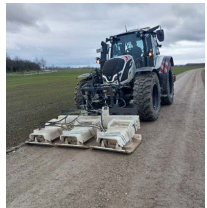
Der Traktor fährt die vorher einprogrammierten Fahrspuren selbstständig ab. Das manuelle Vermessen und Ausstecken entfällt.
